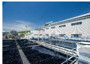
汚泥処理設備
